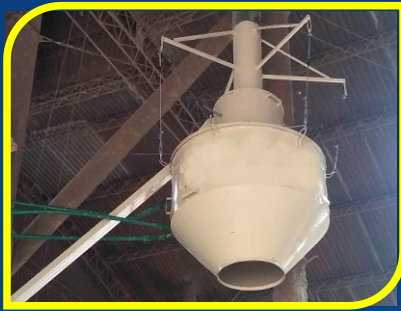
CAMARA DE HUMECTACION
